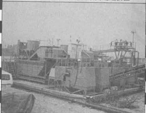
三中央・泥水シールド用泥水処理プラント
