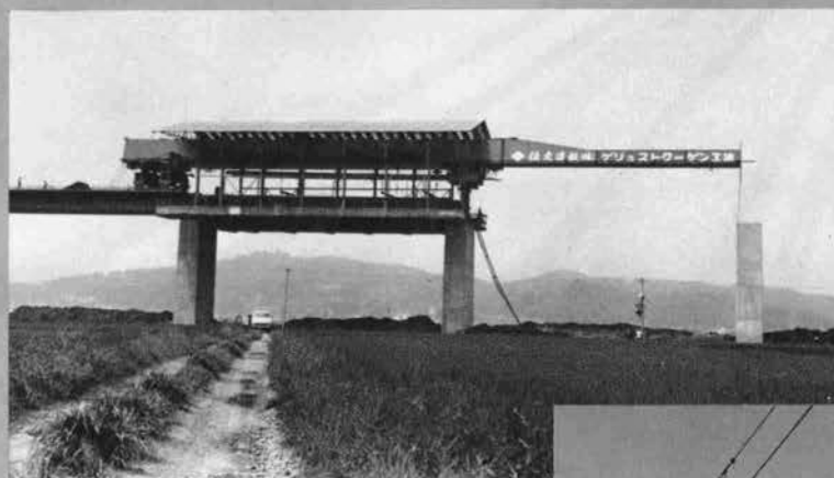
⇨移動つり支保工（ゲリュストワーゲン工法）で施工中の第1北上川橋梁のPCボックス桁
