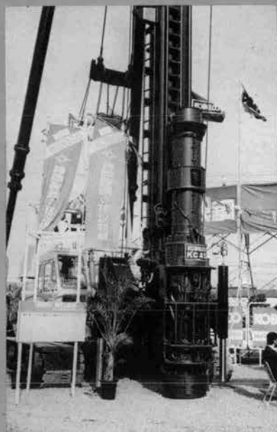
◆ディーゼルパイルハンマの改良も進んでおり、排気がきれいな KC 45 (神戸製鋼)
