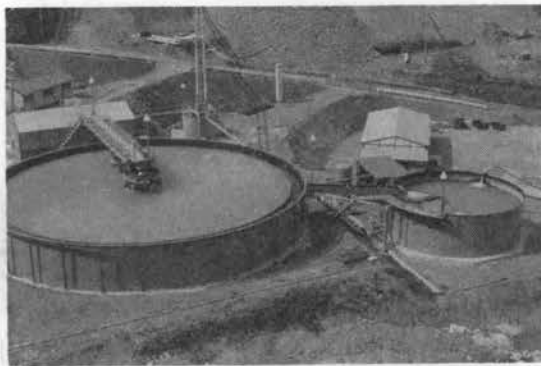
写真-4 骨材プラント用濁水処理設備 (600 m 3 /hr)
