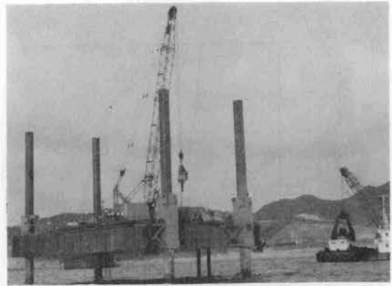
写真-1 組立式自己昇降作業台船 SEP
