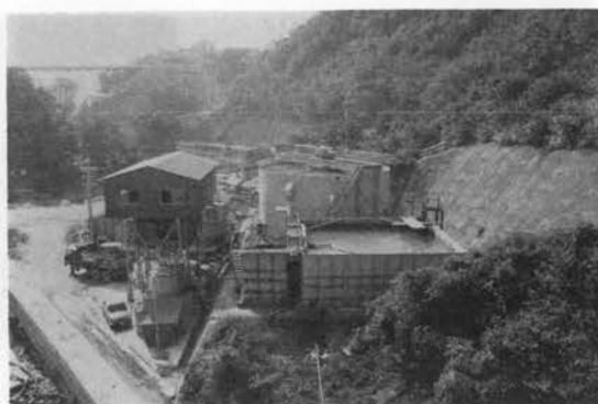
写真-3 ダムサイト用濁水処理設備 ( 300\text{ m}^3/\text{hr} )
