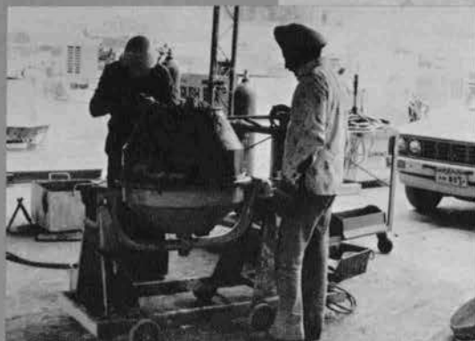
④イラク（バグダッド）／イラクハイラ イズ高層住宅建設工事／コンクリート ミキサの整備（清水建設）
