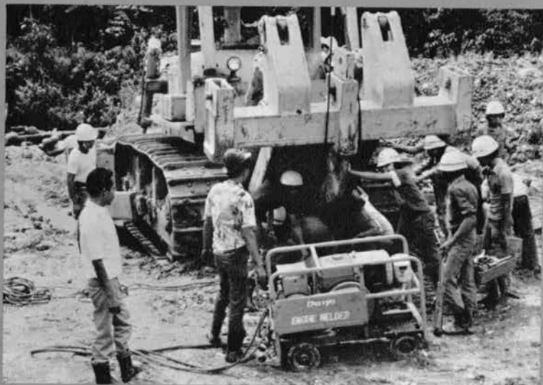
④ インドネシア/マニンジョウ水力発電所土木工事/ブルドーザのリッパチップの交換 (大林組)
