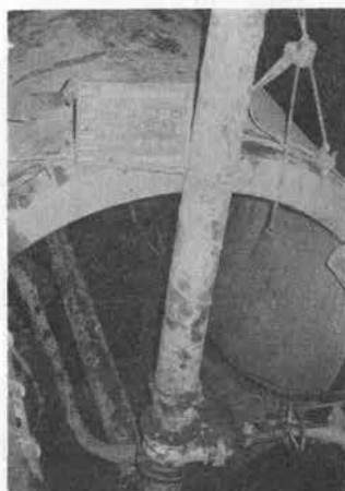
写真-1 モーノポンプ排土管立上り
