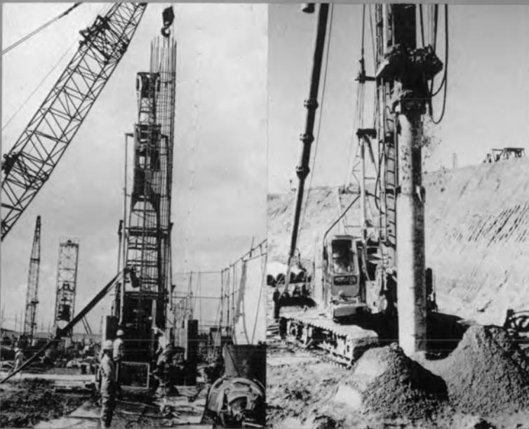
⇨ 栄町高架橋の基礎ベント杭 φ1,500mmの鉄筋建込作業 で、後方はベント杭の掘削 作業中
