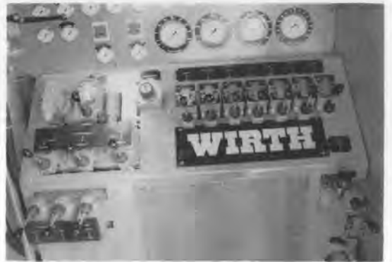
写真-6 運転室（操作レバー、マンメータ類）
