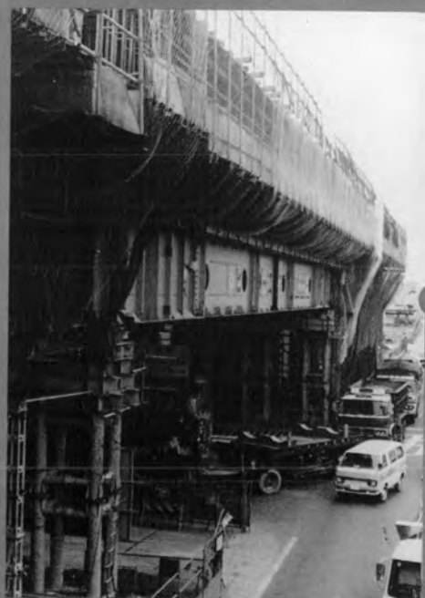
◆ ボックスガーター支保工による3径間連続箱桁の中央径間部(栄町交差点)の施工状況
