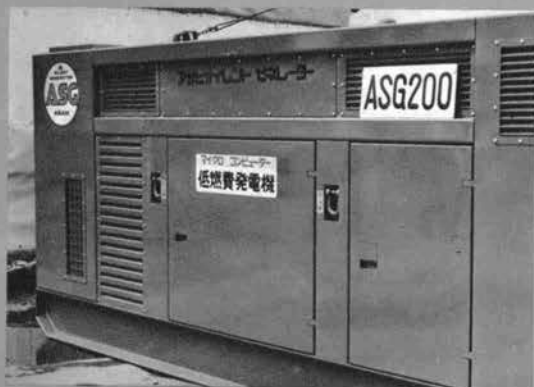
◇サイレントゼネレータ (朝日電機)
