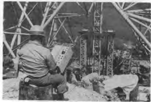
写真-3 CT 65 の地上操作盤
