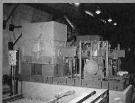
原油払出し用ポンプ （ドライポンプ室内）
