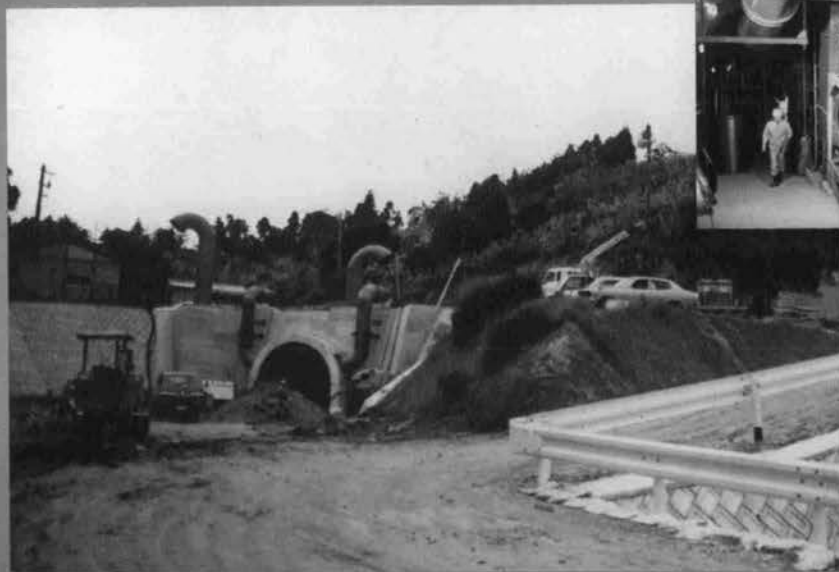
サービストンネル第3坑口（坑内に換気プロアが設けられ、坑口に給気ダクトおよび排気ダクトが取付けられる）
