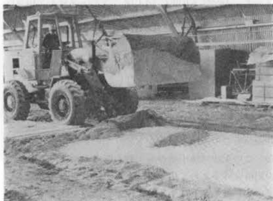
写真-2 砂を充填し、締め固めてからアスファルトを打設する
