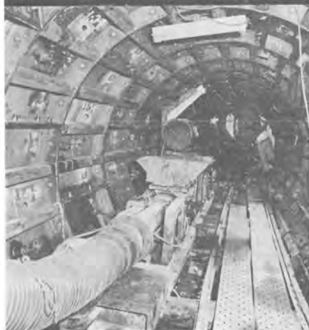
↑東京都足立区千住の管渠シールド作業現場。掘削機から送られてくる粘度の高い泥土をホッパー口に受け、坑口まで圧送する2NES80型。
