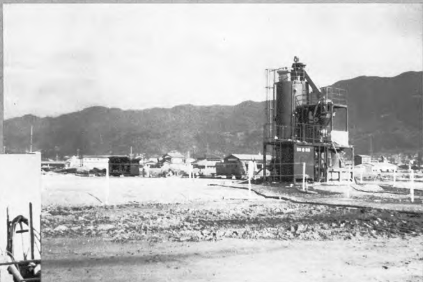
◇無線装置を利用した軟弱地盤処理機用セメントスラリープラント
