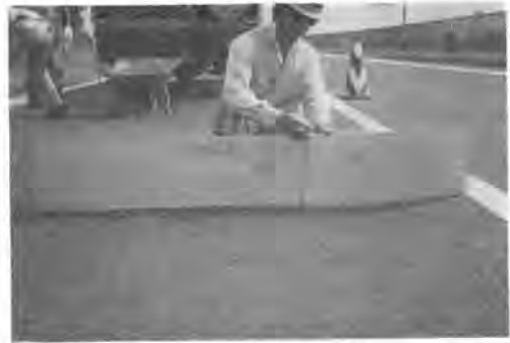
写真-3 わだち掘れ状況(最大30~40mm)
