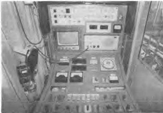
写真-1 M-1 工法操作卓
