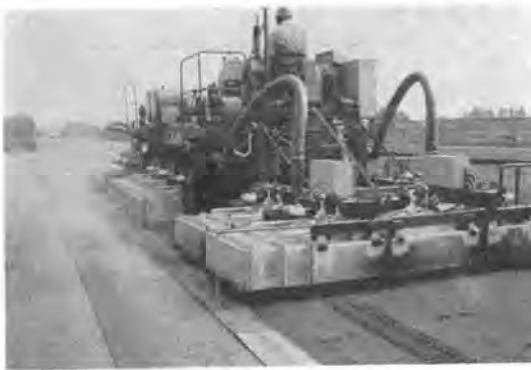
写真-4 路面ヒータ
