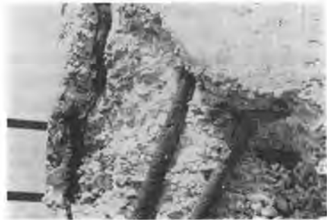
写真-7 コンクリート剥落、錆びた鉄筋
