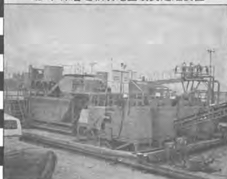
三央・泥水シールド用泥水処理プラント
