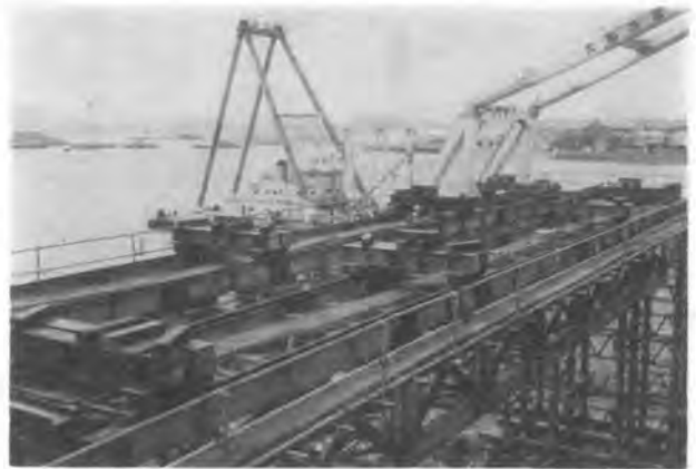
写真-3 P_{101} \sim B_0 ペント間軌条, 台車設備
