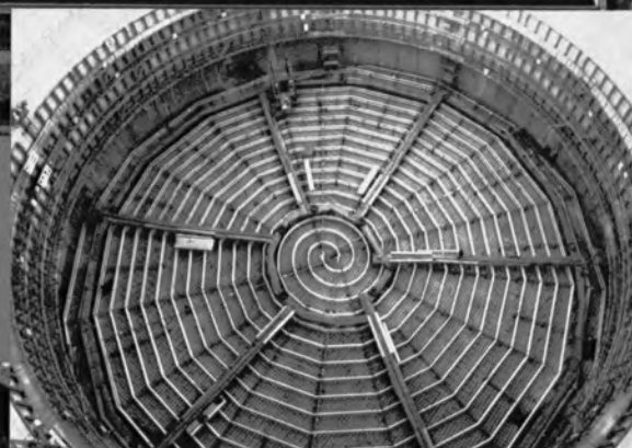
◆底部ヒータ設備
