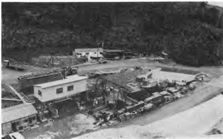
写真-3 濁水処理設備
