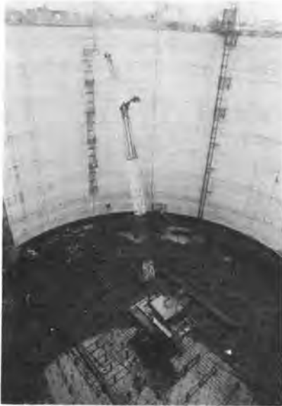
写真-3 貯槽内ジブクレーン
