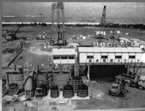
◇連続地中壁泥水処理プラント
