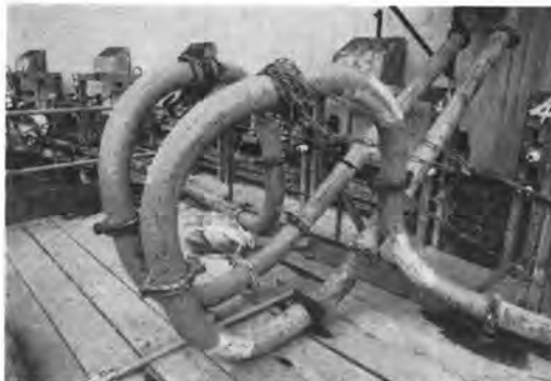
写真-4 ループ配管
