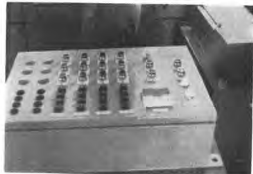
写真-3 垂直施工制御装置操作盤
