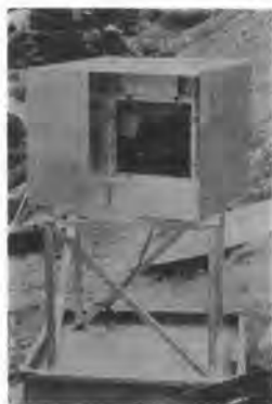
写真-39 VPS を収めたキャビネット
