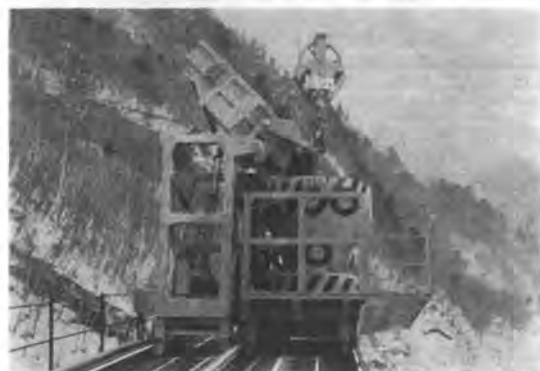
写真-33 電動式コンクリート搬送装置
