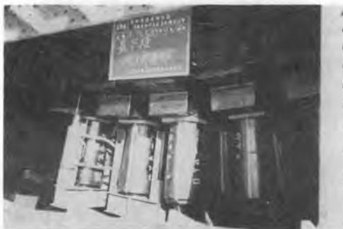
写真-5 ケーブル定着部
