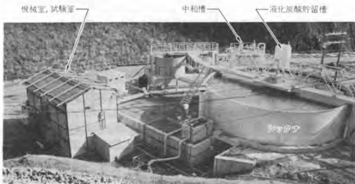
写真-1 濁水処理設備
