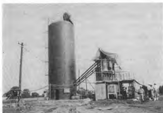
写真-3 深層攪拌混合のプラント設備
