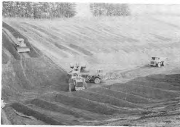
写真-1 積込場の状況
