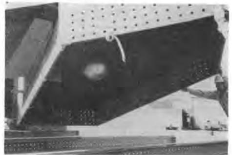
写真-1 柱頭ブロックに仕込まれたピン支承用鋼球
