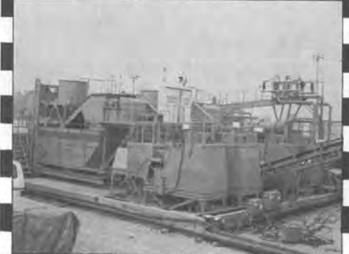
三央・泥水シールド用泥水処理プラント
