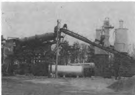
写真-4 ソイルプラント(450 t/hr)
