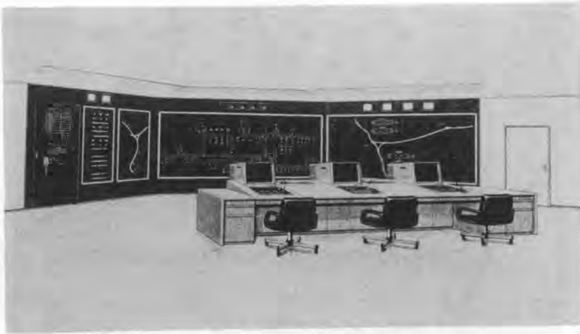
写真-1 中央管制室
