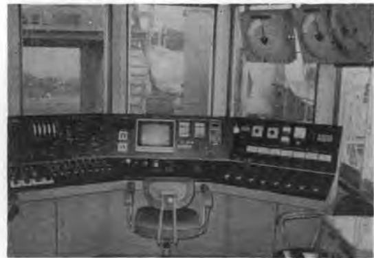
写真-6 プラント操作室
