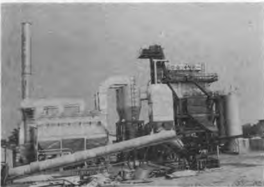
写真-5 アスファルトプラント(240 t/hr)
