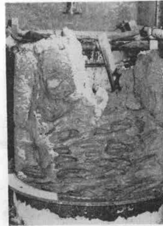
写真-1 蜂の巣状に固結したセメントミルク
