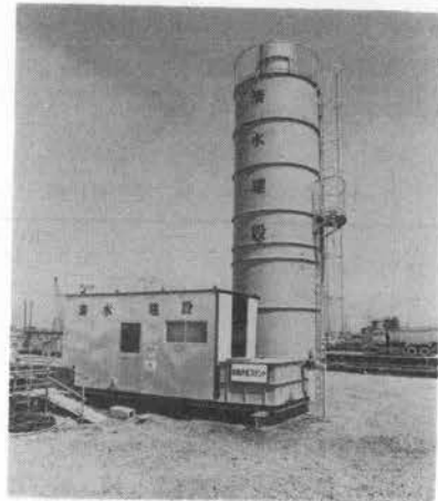
写真-22 自動安定液製造ユニット
