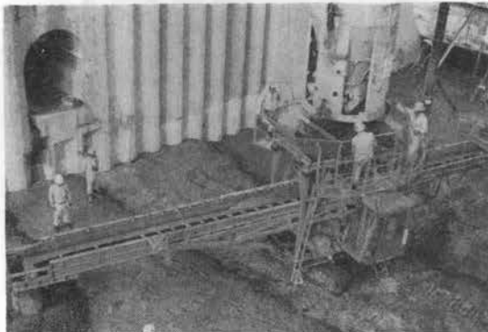
写真-4 コンクリートスプレッドコンベヤ
