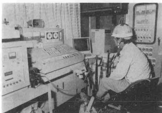
写真-14 全自動運転システム
