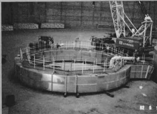
⇨ 屋内貯炭場上部換気用リングダクト
