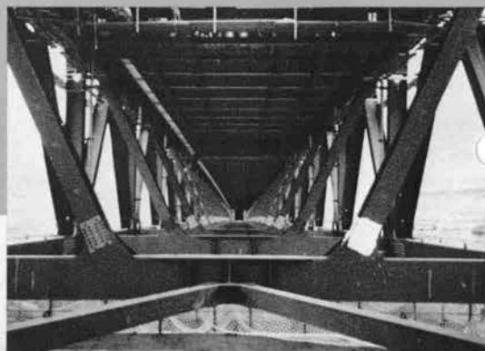
⇨ 検査設備 (手動式)
