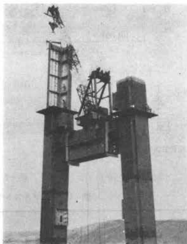
写真-4 塔頂クレーン
