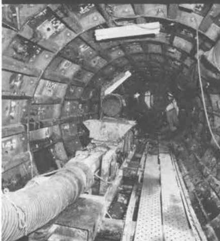
↑東京都足立区千住の管渠シールド作業現場。掘削機から送られてくる粘度の高い泥土をホッパー口を受け、坑口まで圧送する2NES80型。
