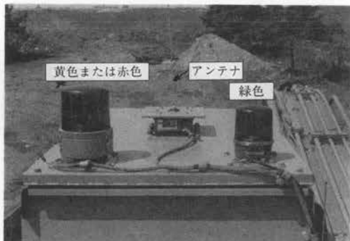
写真-3 警告灯と負荷表示灯
