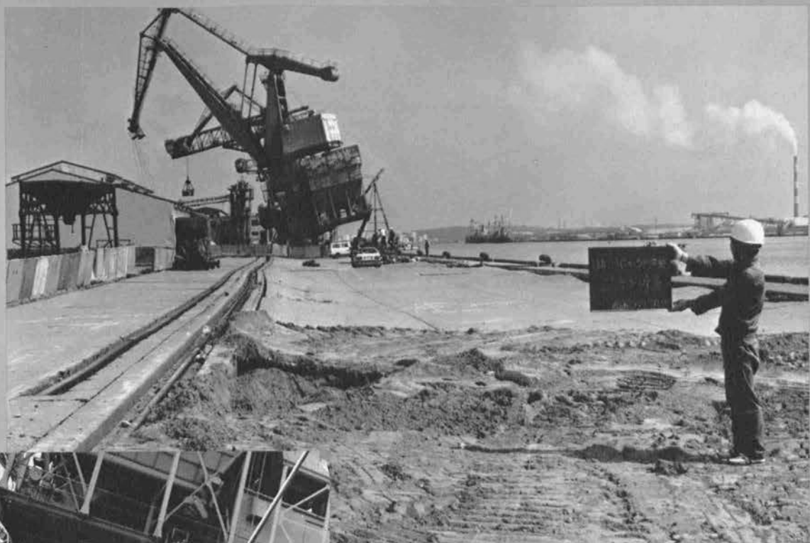
◆エプロン全長にわたり 30 cm 程度沈下 (中島 3 号岸壁)
