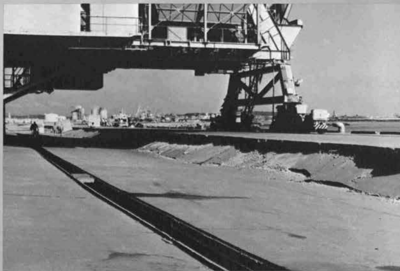
◆エプロンが沈下し、アンロ ーダも傾斜（-13m岸壁）
