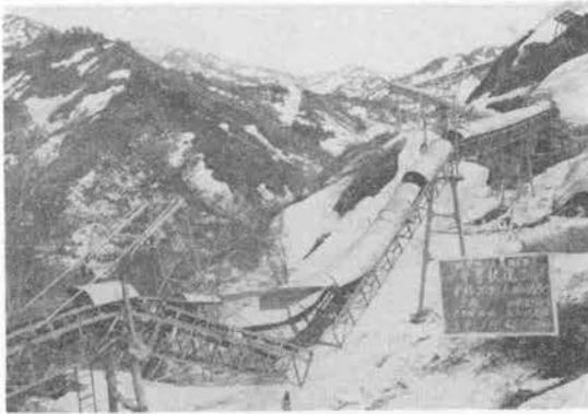
写真-5 斜面雪圧による被害
