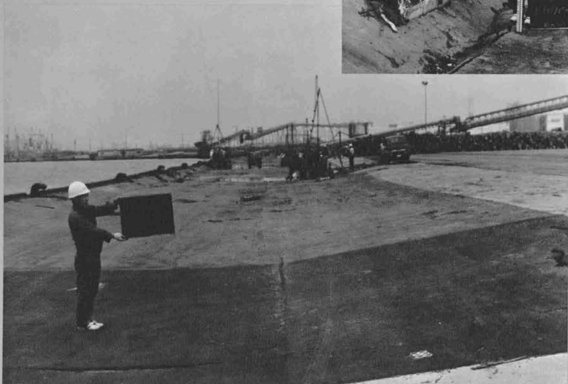
⊕エプロンが全長にわたり約 1 m 沈下 (向浜 2 号岸壁)
