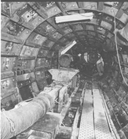
↑東京都足立区千住の管渠シールド作業現場。掘削機から送られてくる粘度の高い泥土をホッパー口に受け、坑口まで圧送する2NES80型。
