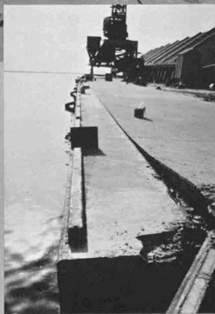
◆岸壁法線のせり出しと傾斜
