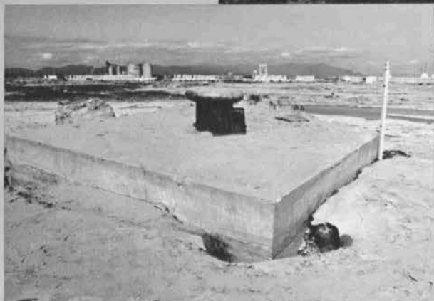
◆液状化現象による係船直柱（200t）傾斜
