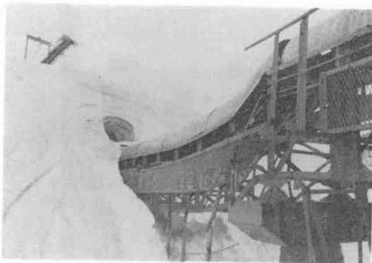
写真—4 積雪の沈降力による被害
