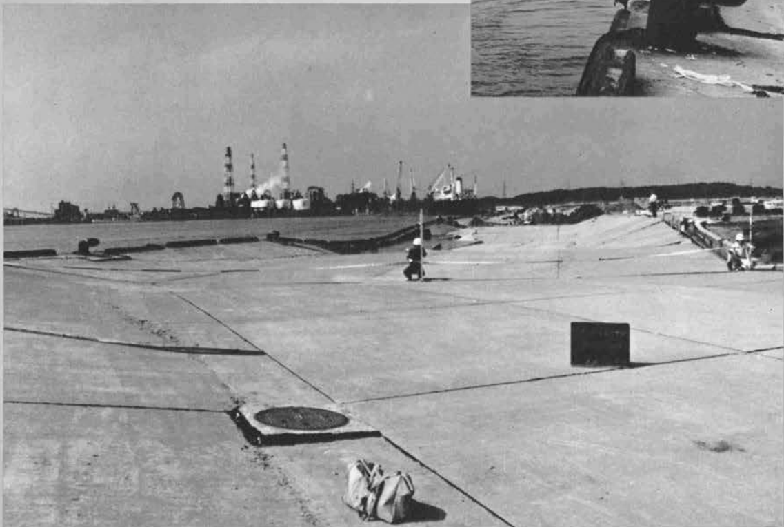
◆約40mが前傾水没し、控工も完全に崩壊（大浜3号岸壁）
