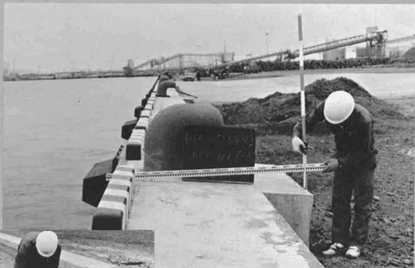
⊕上部工が陸側に向って傾斜 (向浜 3 号岸壁)
