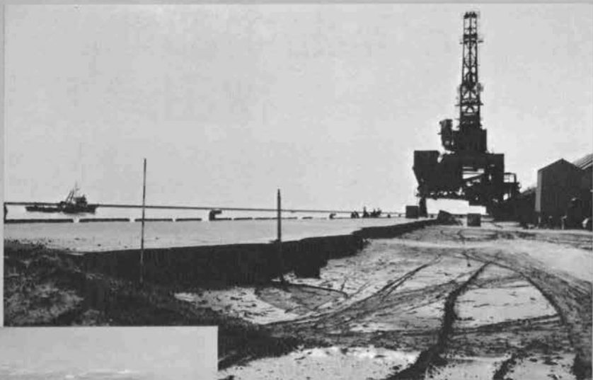
◆エプロンが約1.0～1.5m沈下（-13m岸壁）
