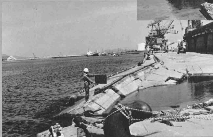
◆約 40 m が完全崩壊 (海側。中島 1 号岸壁)
