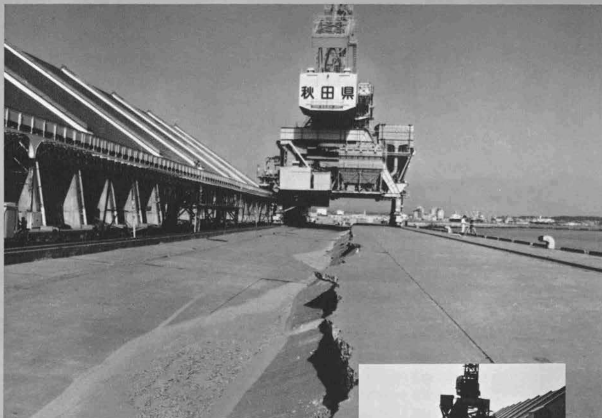
◆エプロンの沈下とクラック（-13m岸壁）
