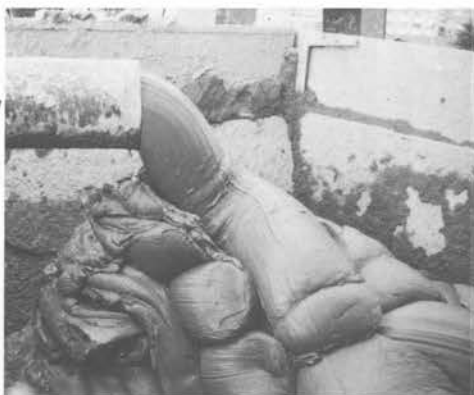
↑東京都の下水幹線工事現場。2NES100型で水平20m、垂直30m送られてホッパーに投入されるシルト (スラップ 幅10cm)
