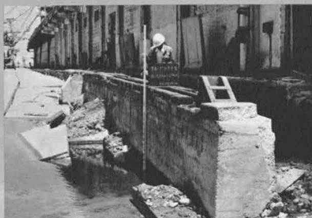
◆約 40 m が完全崩壊 (建屋側。中島 1 号岸壁) ◆
