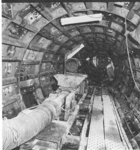
↑東京都足立区千住の管渠シールド作業現場。 掘削機から送られてくる粘度の高い泥土をホッ パー口へ受け、坑口まで圧送する2NES80型。
