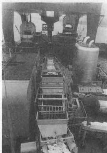
写真-3 アンローダ船上のパイプレーティングスクリーン
