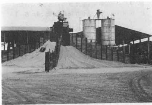
写真—1 2 m 3 コンクリート batching プラント
