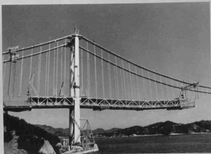
⇨ 補剛桁の変位状況
