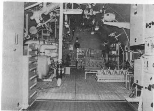
写真-4 マニホールドセンター（上）とその内部（下）
