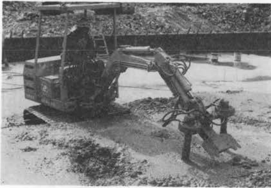
写真-2 コンクリート締固め機
