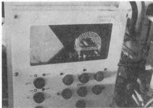
写真-1 コントロールパネル
