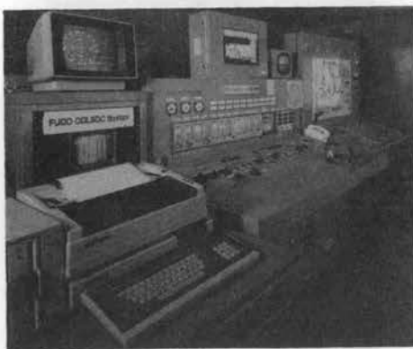
写真—34 中央制御室内の FUDO COLSOC System
