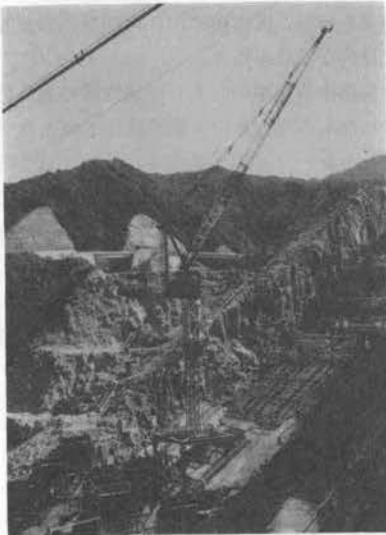
写真-2 タワークレーンの傾斜移動装置
