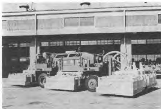
写真-10 新潟 NRH 400 リサイクルヒータ
