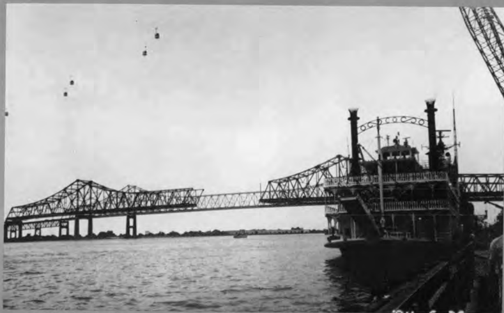
♡ 河川博会場直上流で工事中のニューオーリンズ大橋（ルイジアナ州ニューオーリンズ）
