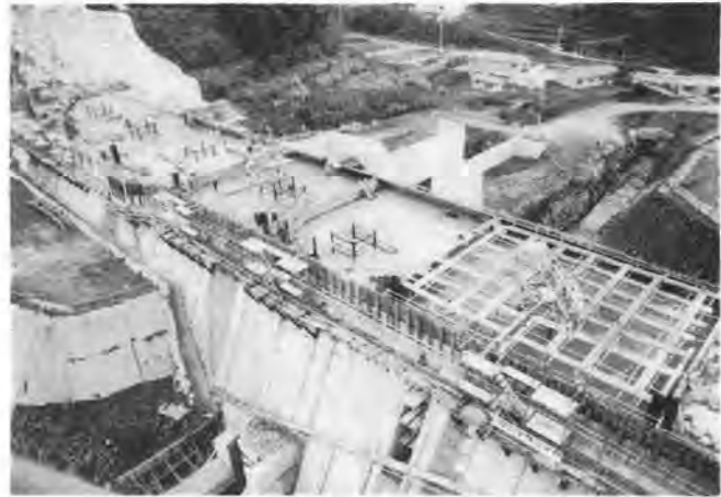
写真-3 ディストリビュータの設置状況
