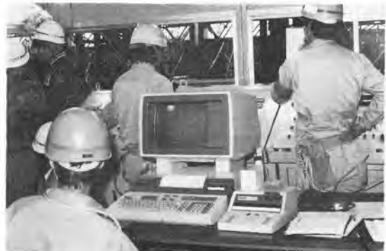
写真-4 中央制御室
