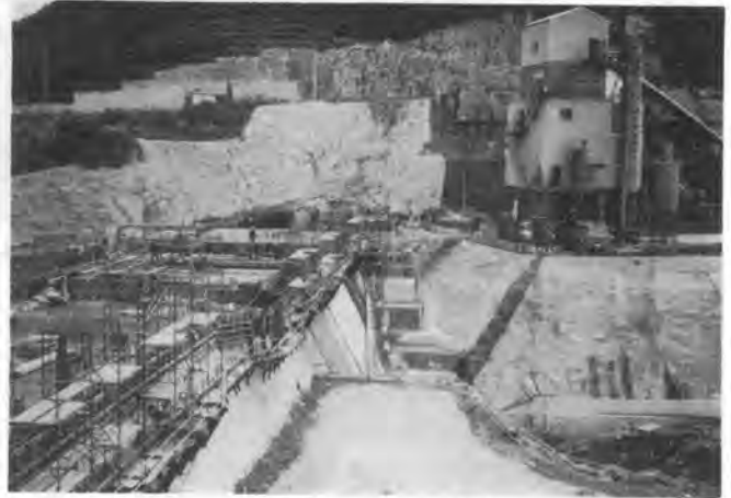
写真-2 システム全景
