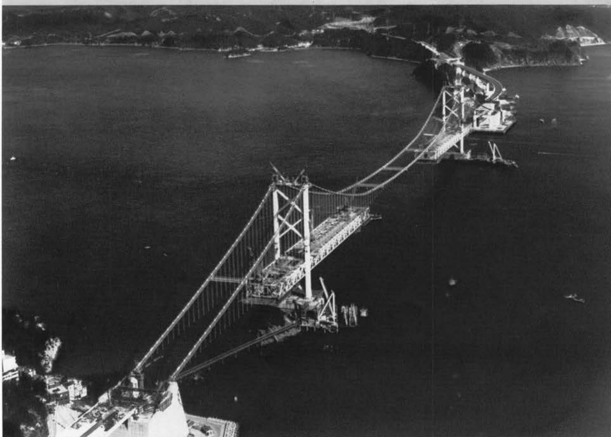
◆上から見た補剛桁架設状況（1カ月2ブロックのペースで約1年を要した）
