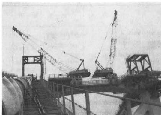
写真-2 塔頂クレーン
