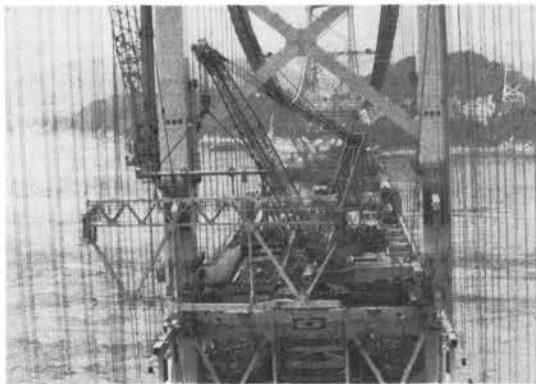
写真-4 トラベラクレーン
