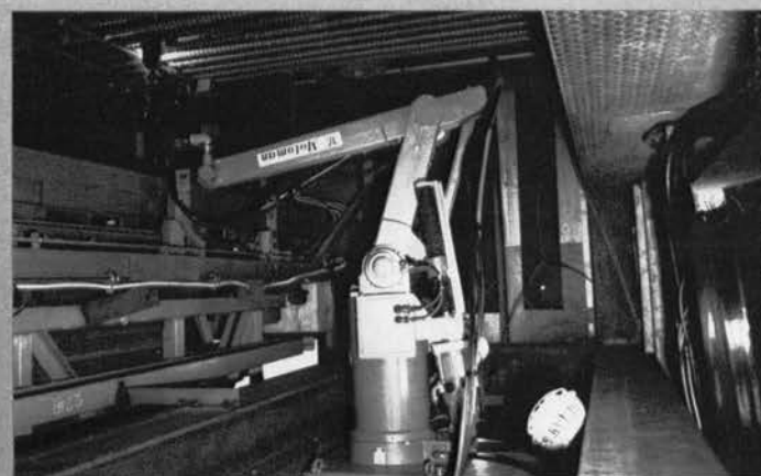
◇地下連続壁用鉄筋かご自動溶接システム ：前田建設工業〔自動溶接位置決め〕
