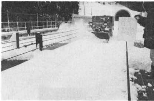
写真-4 強制排除状況
