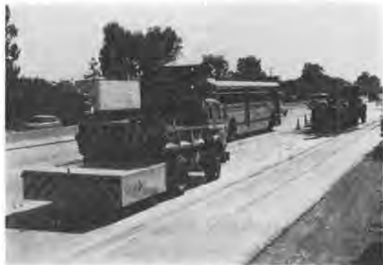
写真-1 緩衝装置の設置例
