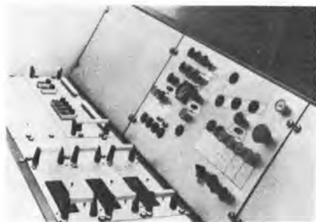
写真-3 コントロールコンソール
