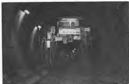
写真—19 トレンコンベヤ設備
