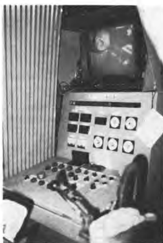
写真-2 シールド機械操作制御室
