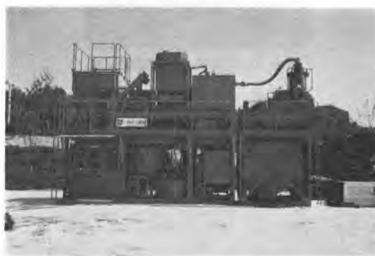
写真-10 ソイルセメントリサイクルプラント
