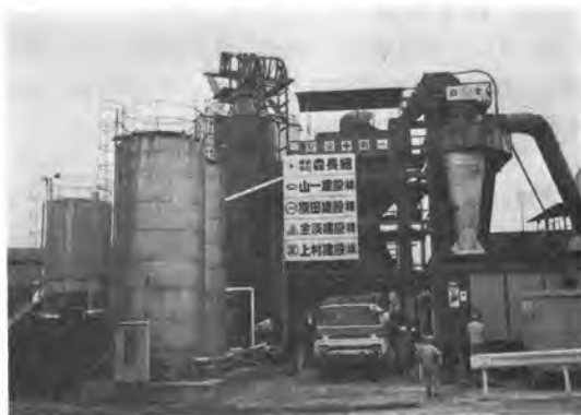
写真-2 アスファルトプラント
