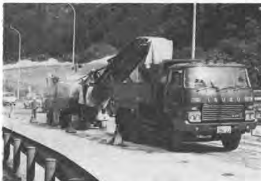
写真-8 コールドブレーナによるコンクリート舗装の切削
