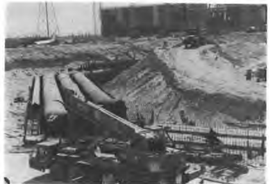
写真-5 C/W Conduit Pipe
