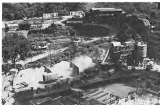
写真-4 パッチャプラント全景
