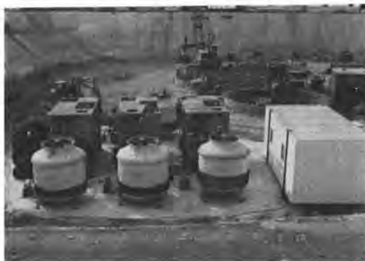
写真-7 クーリング用冷凍機
