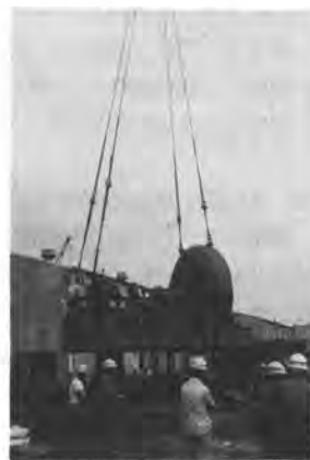
写真-4 ポンプブロック
