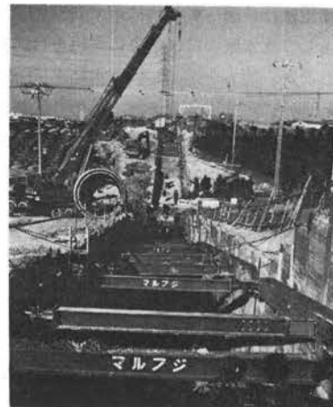
写真-2 バイパスサイホン
