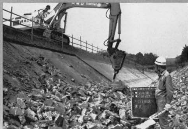
◇既設水路の取壊し 既設水路は、厚さ10cmのコンクリートライニングを施しただけのものではあった
