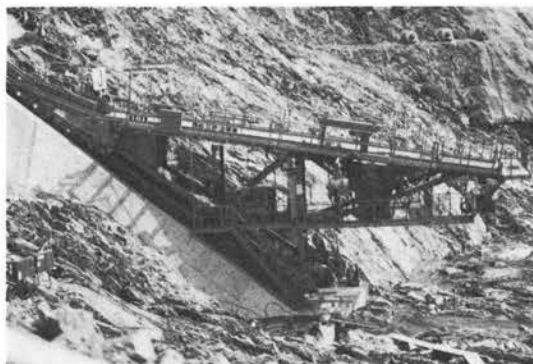
写真-4 3 m 3 ホッパステーション
