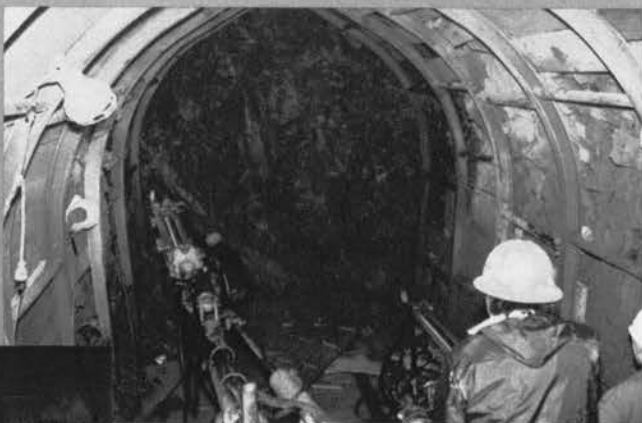
高座山Bトンネル工事 (施工延長786.4m) ⇨ 2ブームジャンボドリルによるさく孔 作業状況
