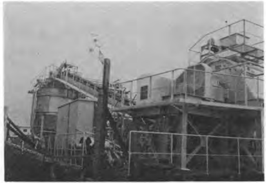
写真-6 プラント全景、製品タンク、破砕機
