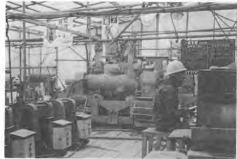
写真-2 WMC 製造プラント
