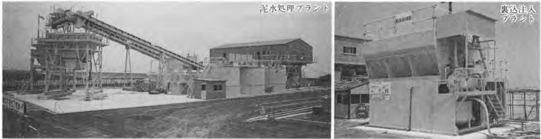
写真-3 陸上諸設備
