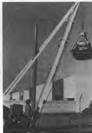
写真-2 Dynahoist システム
