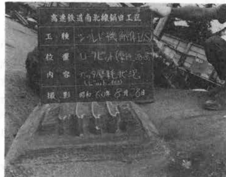
写真-4 ローラビット摩耗状況
