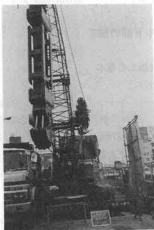
写真-1 クラムシェルロングバケット式掘削機による掘削状況
