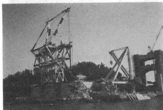
写真-4 現地据付け完了したクリーバクレーンと水切りクレーン
