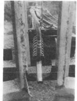
写真-2 エア自動供給装置
