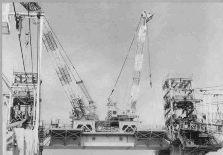
◆塔頂部における ストランド引出し設備
