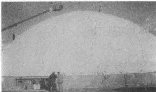
写真-6 コンクリート吹付け前に膨らまされたドーム型枠
