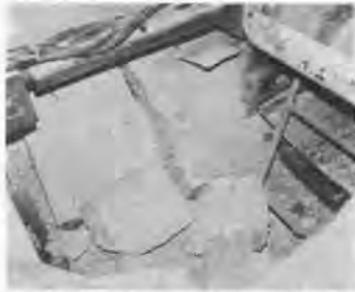
写真-1 MKIによるセグメントの破損
