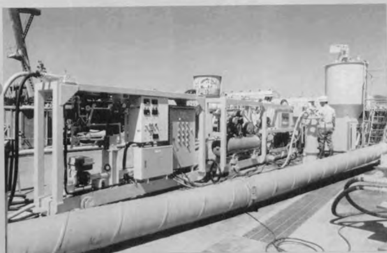
気泡シールド工法設備全景
