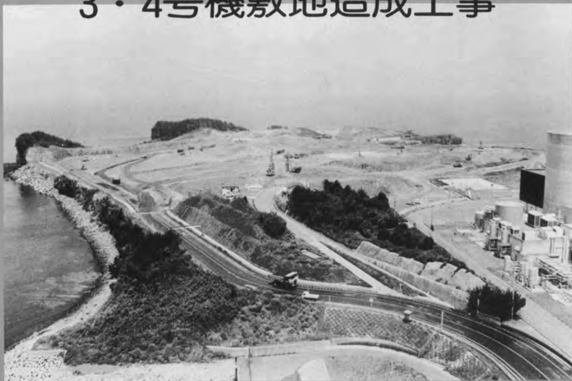
⇨敷地造成区域全景（昭和61年7月末現在、 右端に既設発電所2号機の一部が見える）
