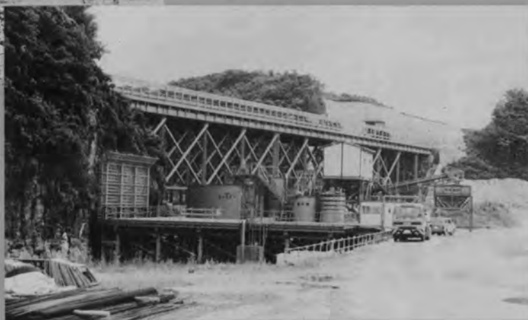
⇨濁水処理設備 （処理能力250m 3 /hr.） 調整池3,000m 3 ）
