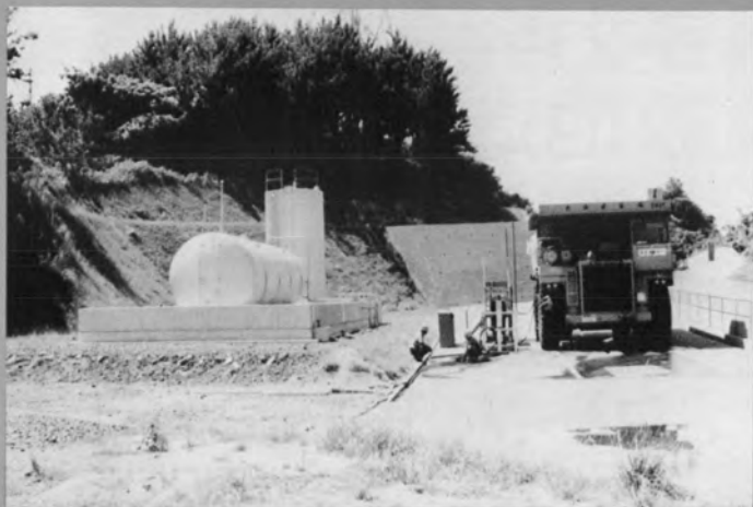
⇨給油設備 (40kl, 20kl タンク各1基)
