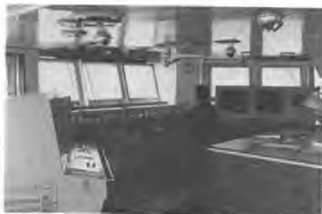
写真-5 主制御室
