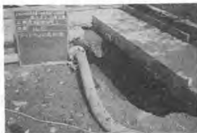
写真-6 ガイドウォール背面崩壊状況
