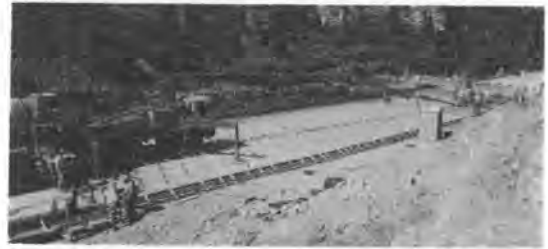
写真-2 シースをいためないよう、コンクリートはポンプとブームにより打設される
