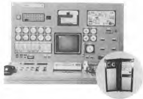
写真-3 中央監視制御盤およびコンピュータ
