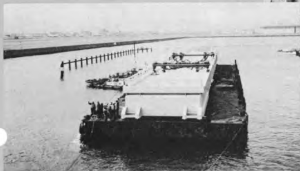
可動部本体 架設するため架設 当日現地近くに係留する
