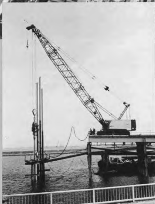
パイプロ 5000 を使用して、80 t クローラクレーンで H-350 の杭を打設する
