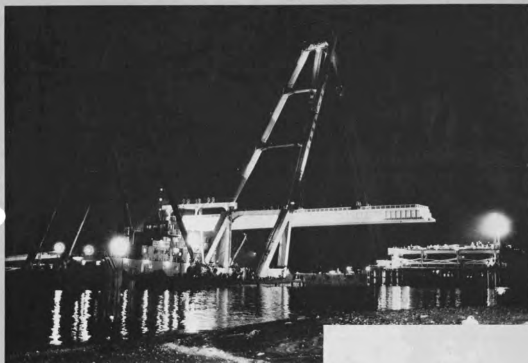
可動部架設 700tフローティングクレーン で空域制限のため、夜間一括架設を行う
