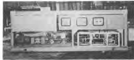
写真-1 気泡注入制御設備
