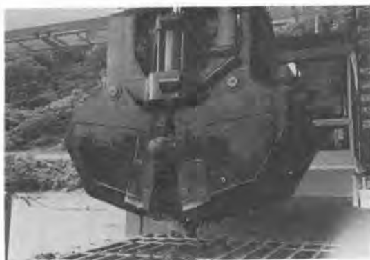
写真-3 グラブバケットの沈木噛込み状況
