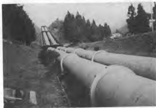
写真-3 黒又川第1発電所水圧管路
