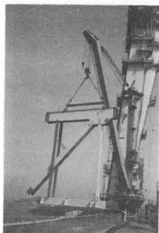
写真-10 塔付ジブクレーン (HB 3P)
